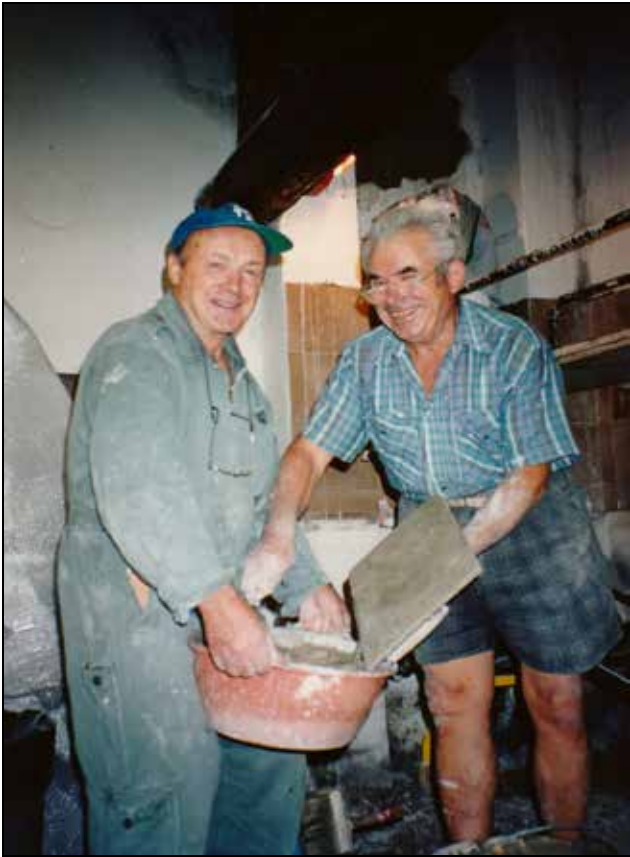
Ecco al lavoro Valerio Boria ed Ermanno Colosetti – muratori tutto fare – elettricisti, imbianchini e chi più ne ha più ne metta.
